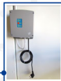
Armoire de commande déjà fixée sur coulisse avec équerre support. 3 boutons en façade + moteur déjà raccordé + cordon secteur raccordé
